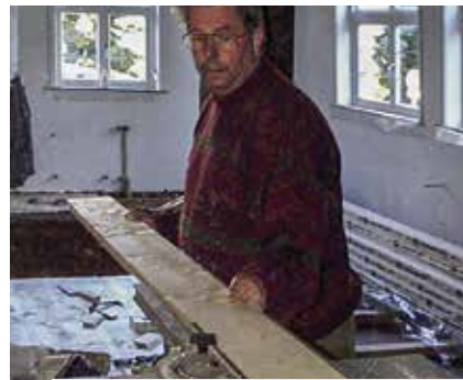
Hier muss noch eine Feder weg
